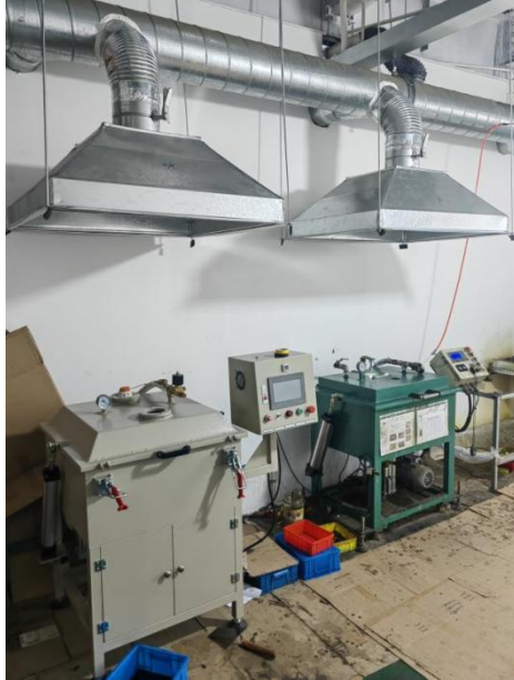
浸漆工段集气罩收集
